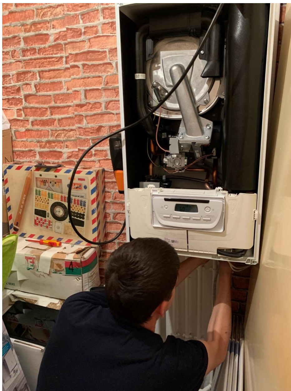
Légende : Un professionnel du gaz règle la chaudière
